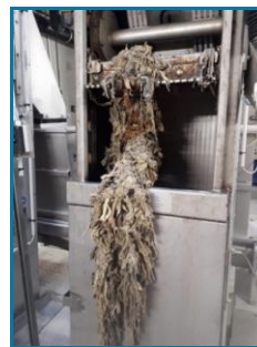
Défaut de dégrillage en station d'épuration
