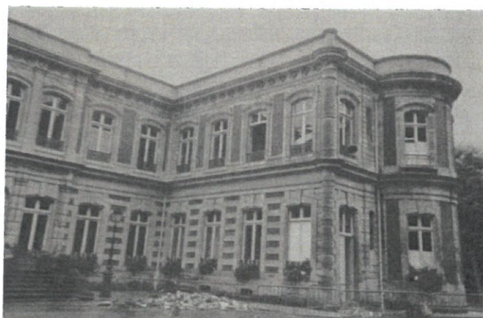
Fig.32 : Vue de la façade ouest avec dégât d'une partie du plafond du Château de La Falaise, 1975, AMP, n°30
